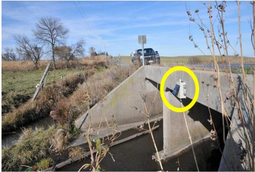
Σχήμα: Σταθμήμετρο με αισθητήρα υπερήχων σε γέφυρα (Tekle, 2014)
